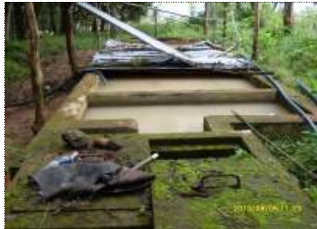
Foto N° 2 Condiciones actuales del desarenar- acueducto Casco Urbano Paratebueno
